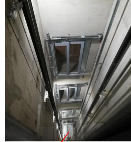
Ascenseurs – cage sud
